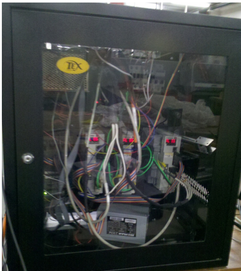
Figura 45 - Gabinete que abriga o sistema elétrico
